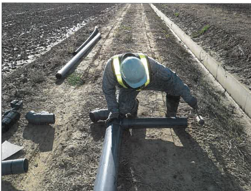
写真区分:施工状況写真 工種:2工区 田番 104-3 種別:水閘工状況 写真タイトル:水閘部組立接着状況
