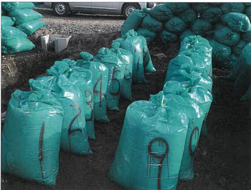
写真区分:施工状況写真 工種:2工区 田番 104-3 種別:吸水渠状況 写真タイトル:モミガラ積込み数量確認
