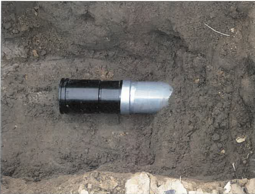
写真区分:施工状況写真 工種:2工区 田番 104-3 種別:取水工状況 写真タイトル:取水工部布設完了
