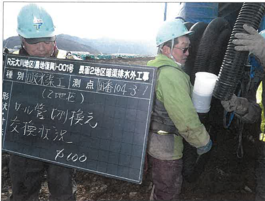
写真区分:施工状況写真 工種:2工区 田番 104-3 種別:吸水渠状況 写真タイトル:ロール管接続 差し込み状況
