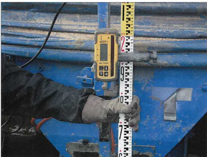
写真区分:施工状況写真 工種:2工区 田番 104-3 種別:吸水渠状況 写真タイトル:発進部管布設 高確認状況
