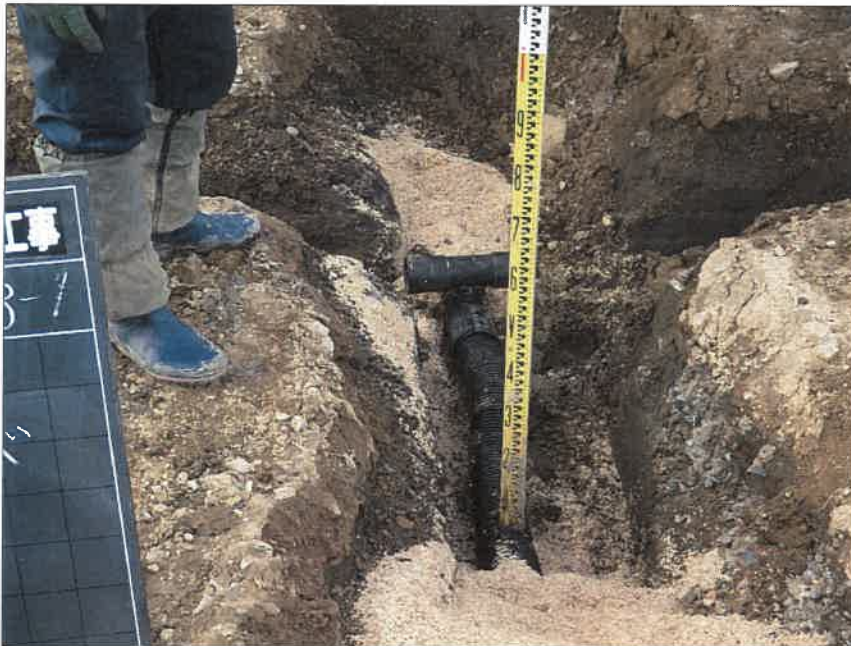
写真区分:施工状況写真 工種:2工区 田番 104-3 種別:吸水渠状況 写真タイトル:到達部管布設 高確認
