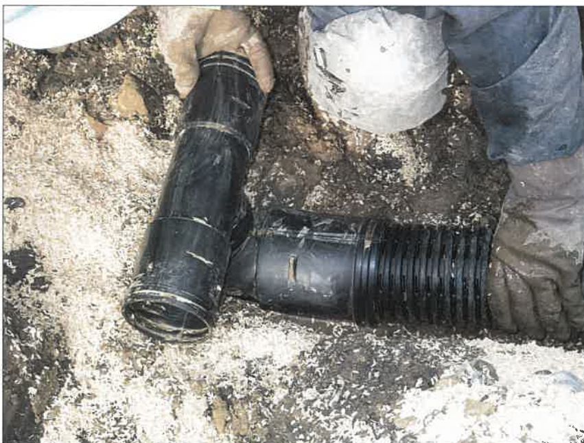
写真区分: 施工状況写真 工種: 2工区 田番 104-3 種別: 吸水渠状況 写真タイトル: 到達部管接続 状況
