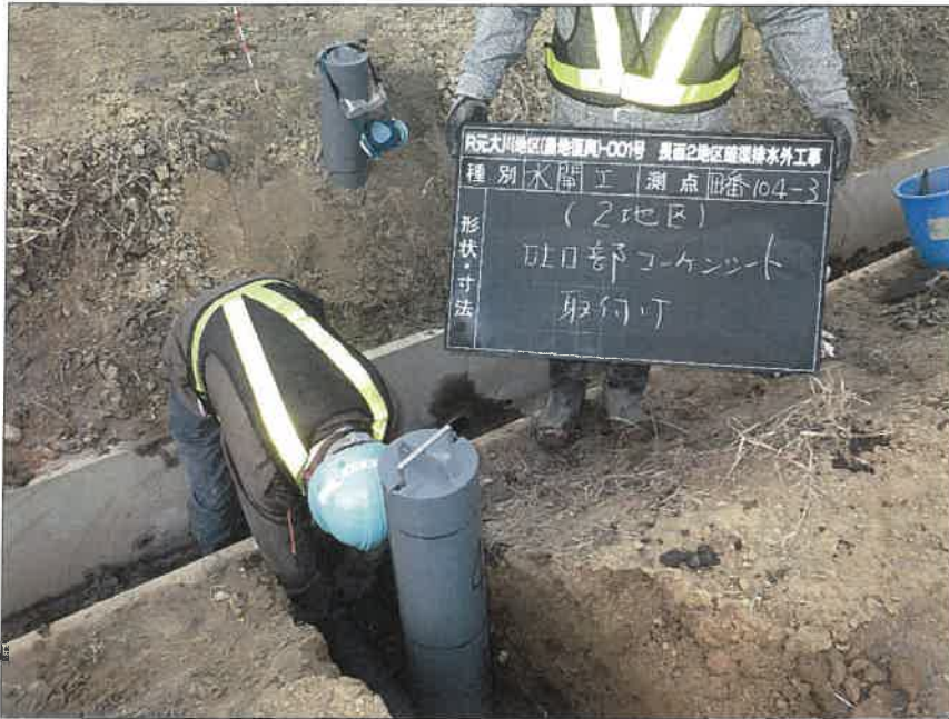
写真区分:施工状況写真 工種:2工区 田番 104-3 種別:水開工状況 写真タイトル:コーキングシート取付
