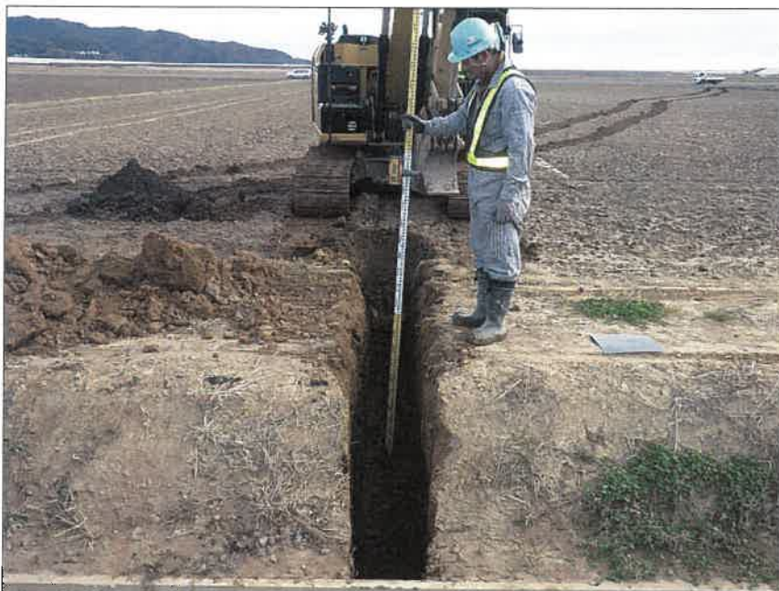
写真区分:施工状況写真 工種:2工区 田番 104-3 種別:水閘工状況 写真タイトル:掘削高測定確認状況
