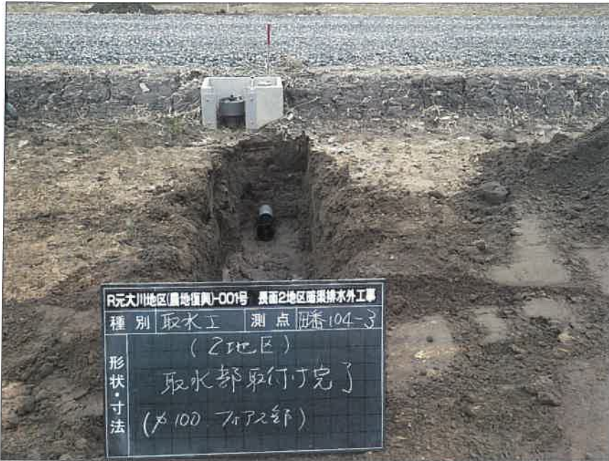
写真区分:施工状況写真 工種:2工区 田番 104-3 種別:取水工状況 写真タイトル:取水工部布設完了
