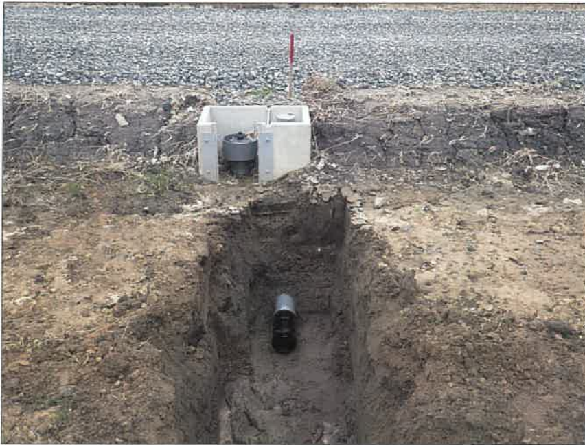
写真区分:施工状況写真 工種:2工区 田番 104-3 種別:取水工状況 写真タイトル:取水工部布設完了
