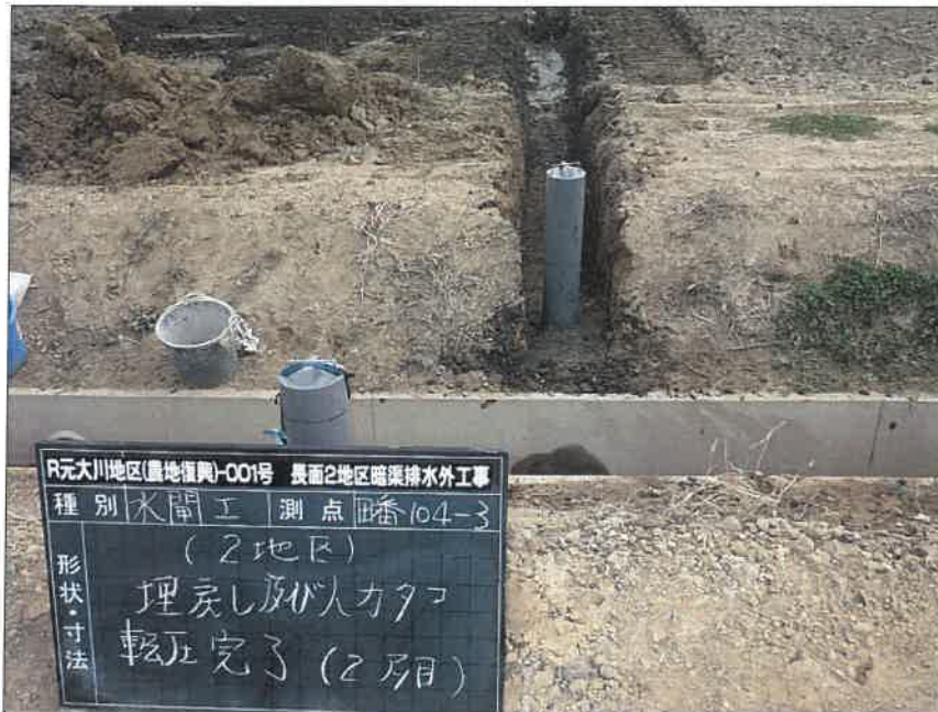
写真区分: 施工状況写真 工種: 2工区 田番 104-3 種別: 水閘工状況 写真タイトル: 埋戻し及び人 力タコ転圧完了
