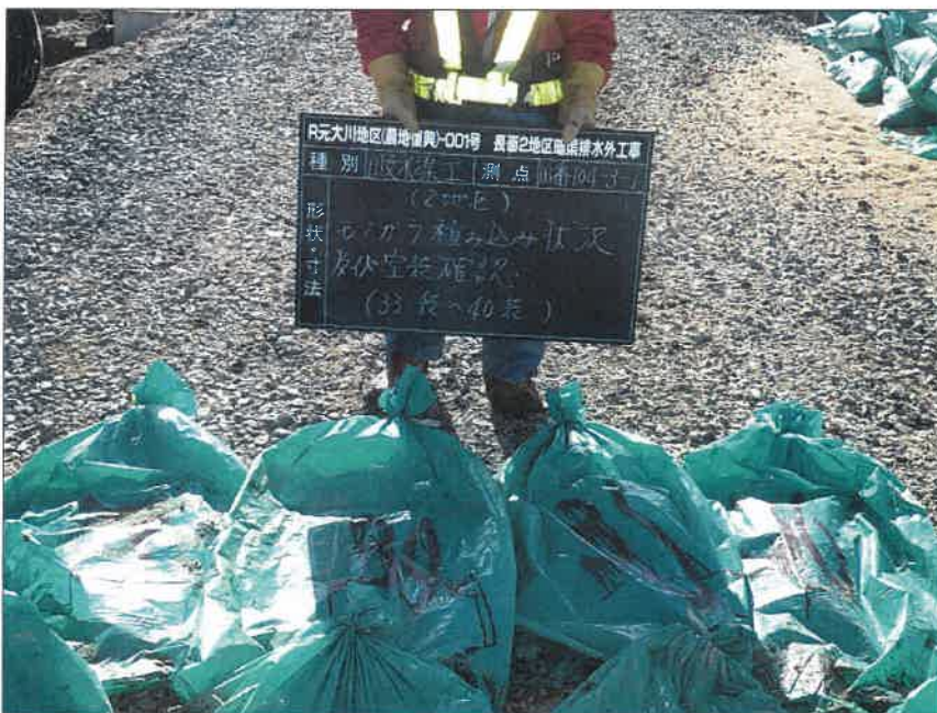
写真区分:施工状況写真 工種:2工区 田番 104-3 種別:吸水渠状況 写真タイトル:ゴミガラ積み 込み後空袋確認
