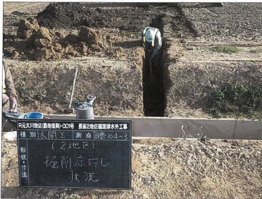
写真区分:施工状況写真 工種:2工区 田番 104-3 種別:水閘工状況 写真タイトル:床均し状況
