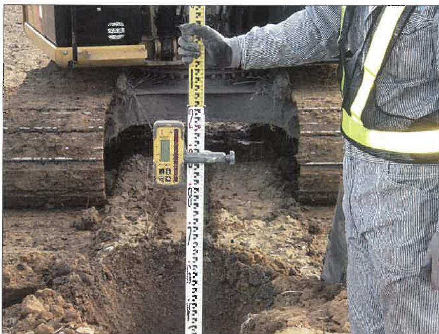
写真区分: 施工状況写真 工種: 2工区 田番 104-3 種別: 水閘工状況 写真タイトル: 掘削高測定確認状況
