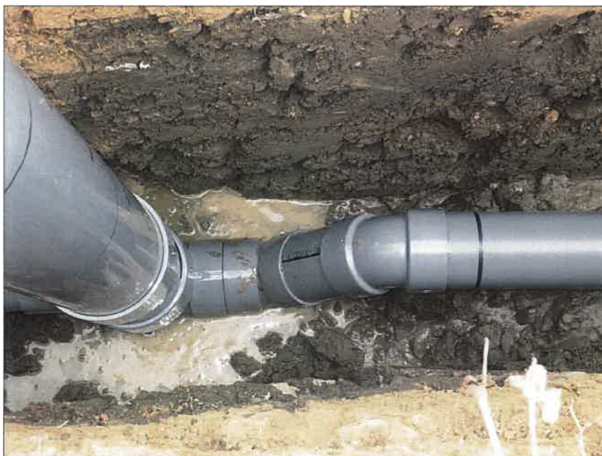
写真区分:施工状況写真 工種:2工区 田番 104-3 種別:水閘工状況 写真タイトル:水閘部設置完了
