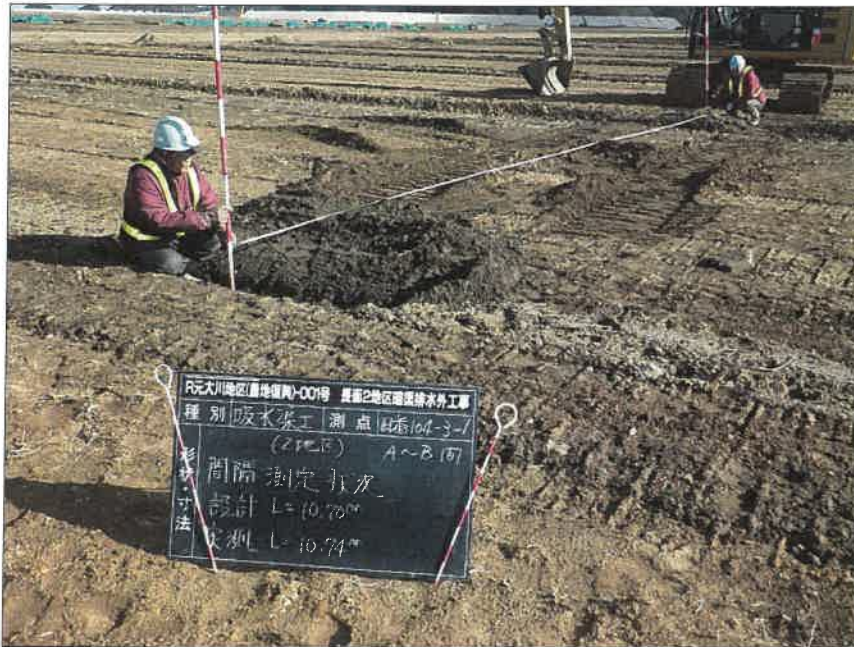
写真区分: 施工状況写真 工種: 2工区 田番 104-3 種別: 吸水渠状況 写真タイトル: 間隔測定状況
