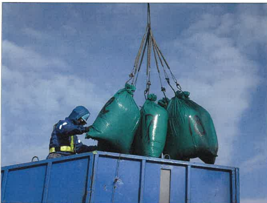
写真区分:施工状況写真 工種:2工区 田番 104-3 種別:吸水渠状況 写真タイトル:モミガラ積み込み状況
