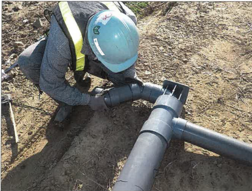
写真区分:施工状況写真 工種:2工区 田番 104-3 種別:水閘工状況 写真タイトル:水閘部組立接着状況
