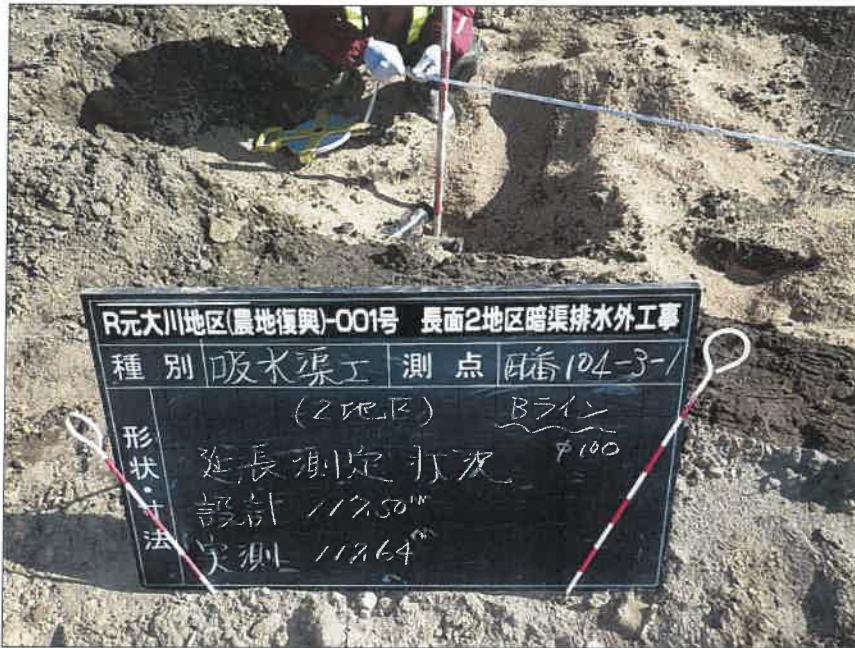
写真区分:施工状況写真 工種:2工区 田番 104-3 種別:吸水渠状況 写真タイトル:延長測定状況
