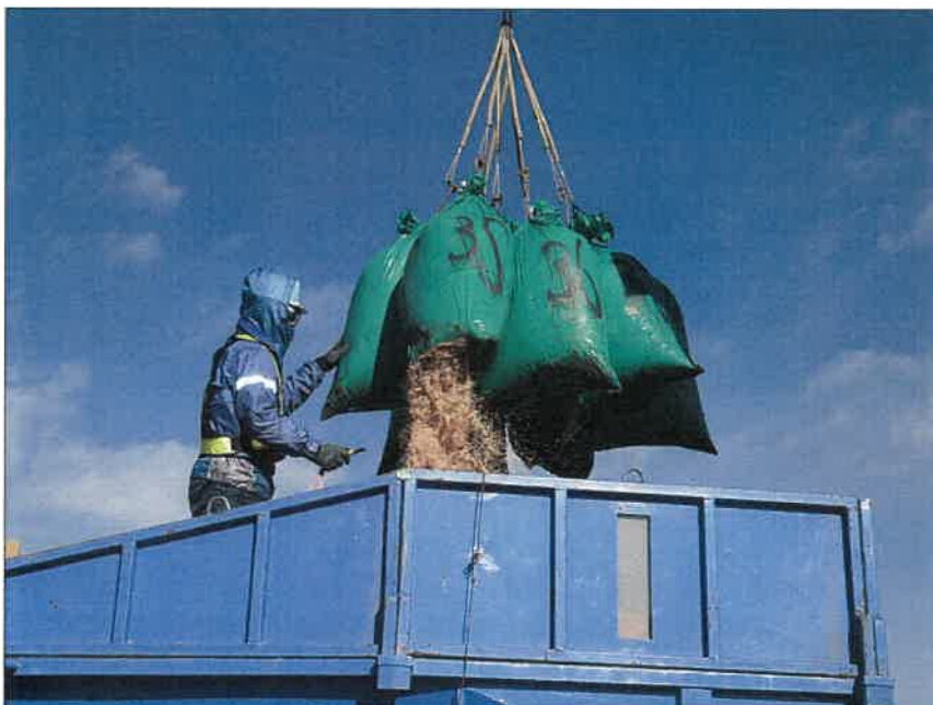
写真区分:施工状況写真 工種:2工区 田番 104-3 種別:吸水渠状況 写真タイトル:モミガラ積込み状況
