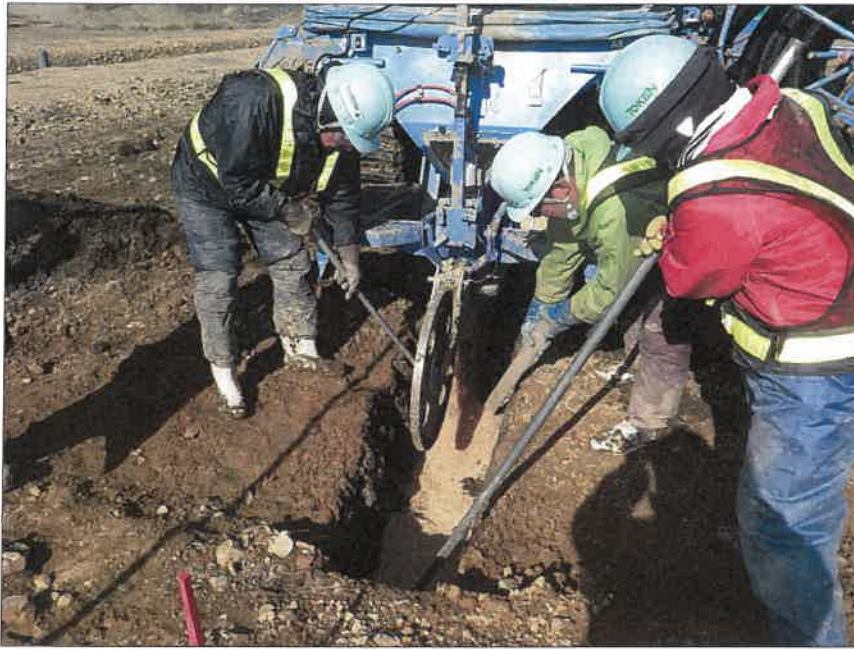
写真区分: 施工状況写真 工種: 2工区 田番 104-3 種別: 吸水渠状況 写真タイトル: 接続部モミガラ投入状況
