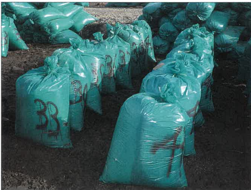
写真区分:施工状況写真 工種:2工区 田番 104-3 種別:吸水渠状況 写真タイトル:モミガラ積込み数量確認
