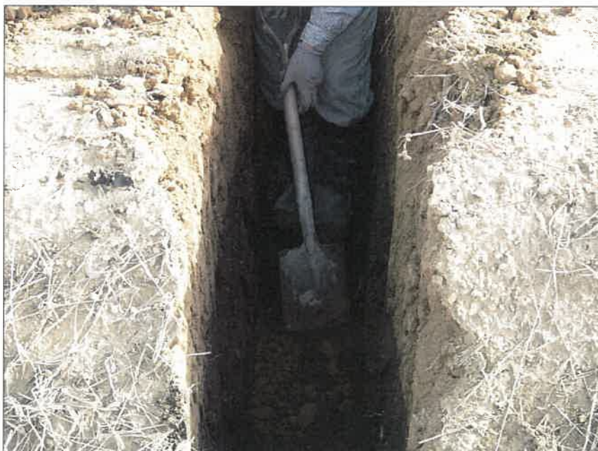
写真区分:施工状況写真 工種:2工区 田番 104-3 種別:水閘工状況 写真タイトル:床均し状況
