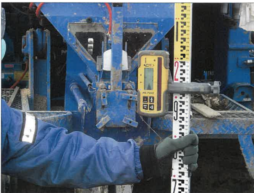
写真区分:施工状況写真 工種:2工区 田番 104-3 種別:吸水渠状況 写真タイトル:到達部管布設 高確認
