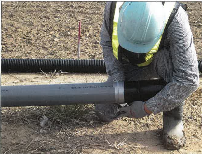
写真区分:施工状況写真 工種:2工区 田番 104-3 種別:水閘工状況 写真タイトル:ポリ塩ビソケット取付
