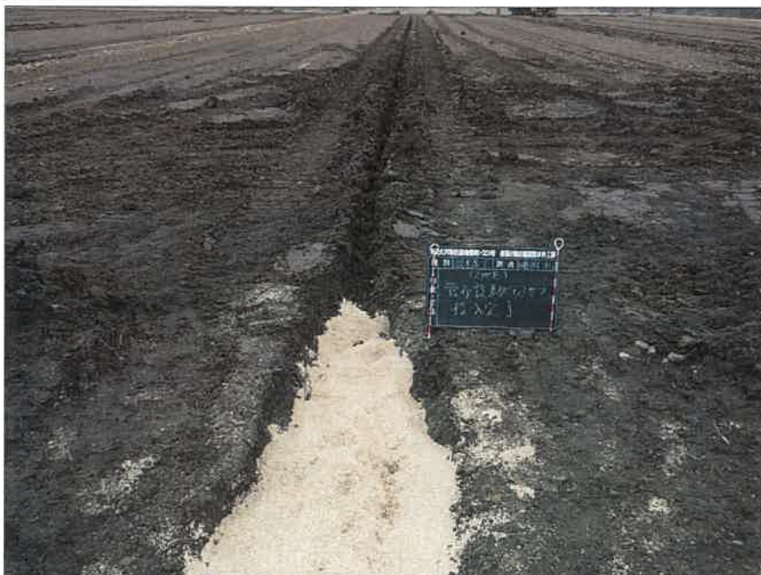
写真区分:施工状況写真 工種:2工区 田番 104-3 種別:吸水渠状況 写真タイトル:管布設.モミ ガラ投入完了
