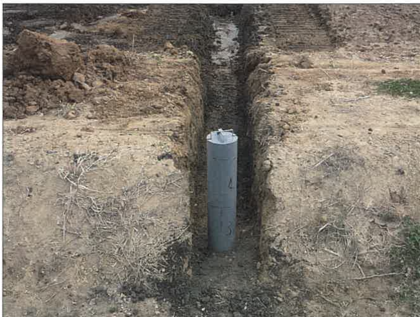
写真区分: 施工状況写真 工種: 2工区 田番 104-3 種別: 水閘工状況 写真タイトル: 埋戻し及び人 力タコ転圧完了
