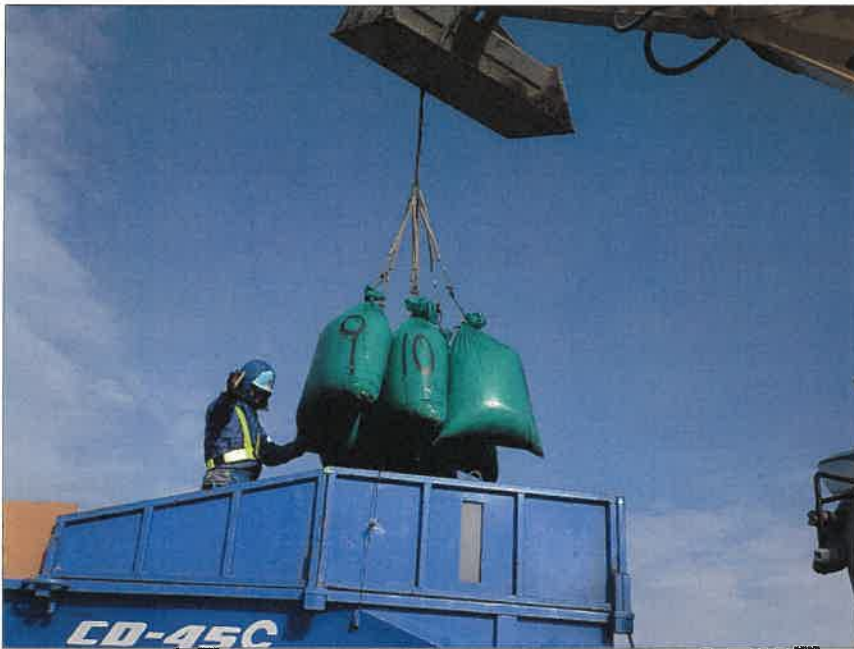
写真区分: 施工状況写真 工種: 2工区 田番 104-3 種別: 吸水渠状況 写真タイトル: モミガラ積み込み状況
