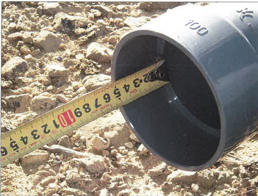
写真区分: 施工状況写真 工種: 2工区 田番 104-3 種別: 水閘工状況 写真タイトル: 水閘部組立差し込み状況
