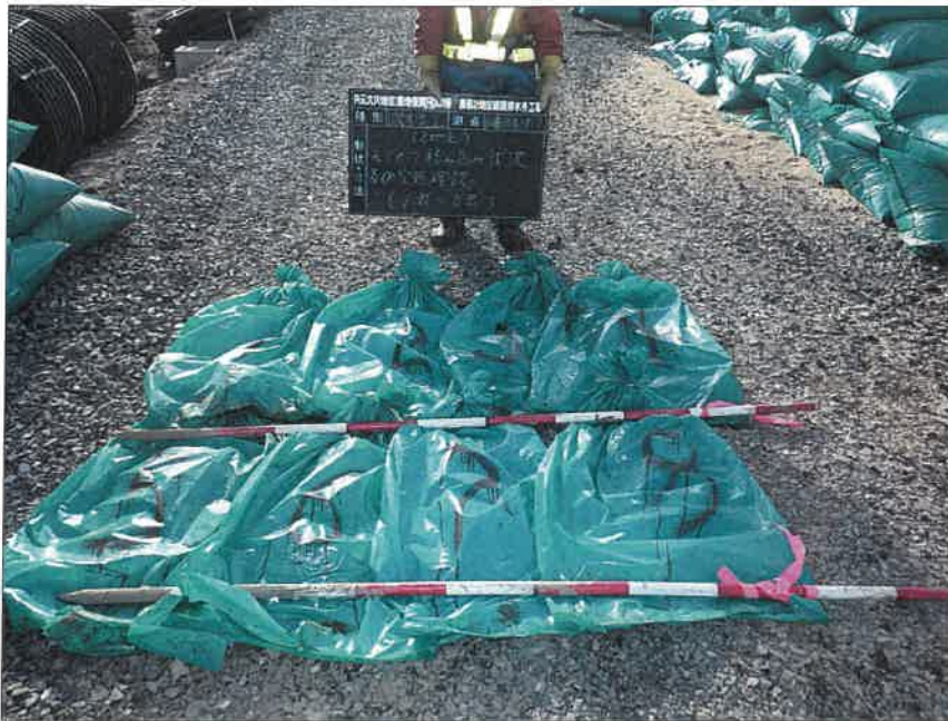
写真区分: 施工状況写真 工種: 2工区 田番 104-3 種別: 吸水渠状況 写真タイトル: モミガラ積込み後空袋確認
