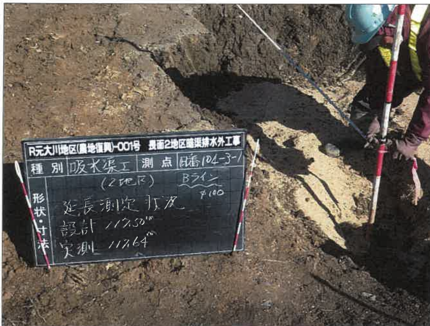
写真区分: 施工状況写真 工種: 2工区 田番 104-3 種別: 吸水渠状況 写真タイトル: 延長測定状況
