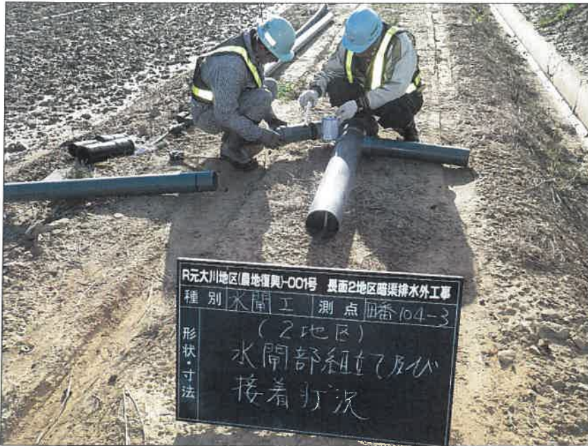
写真区分:施工状況写真 工種:2工区 田番 104-3 種別:水閘工状況 写真タイトル:水閘部組立接着状況
