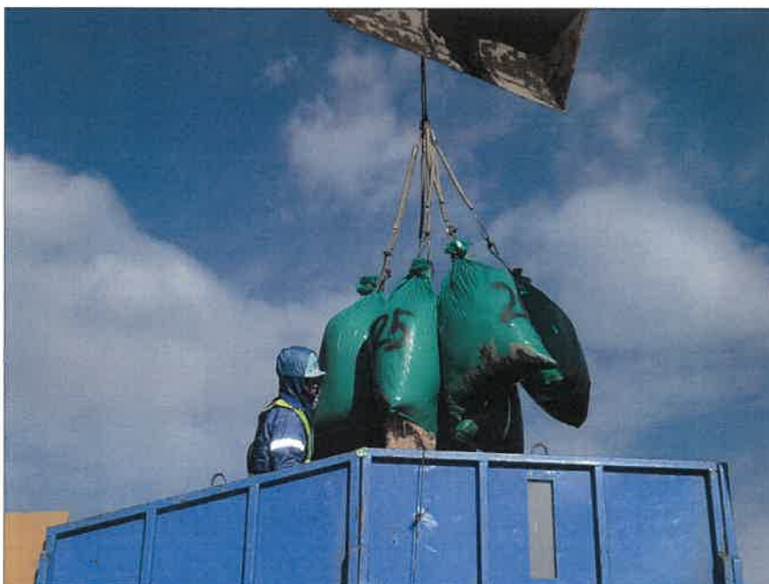
写真区分: 施工状況写真 工種: 2工区 田番 104-3 種別: 吸水渠状況 写真タイトル: モミガラ積み込み状況
