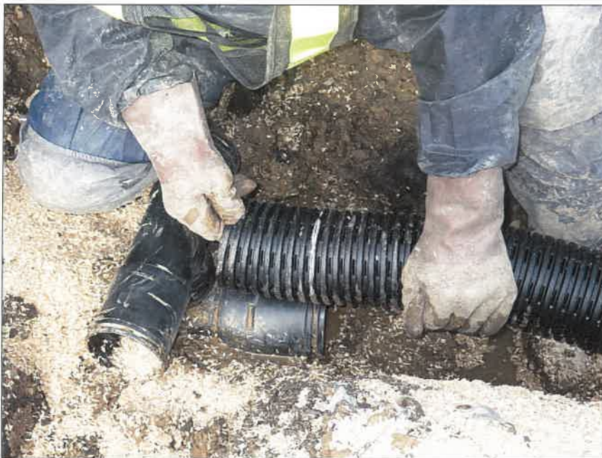
写真区分: 施工状況写真 工種: 2工区 田番 104-3 種別: 吸水渠状況 写真タイトル: 到達部管接続 状況
