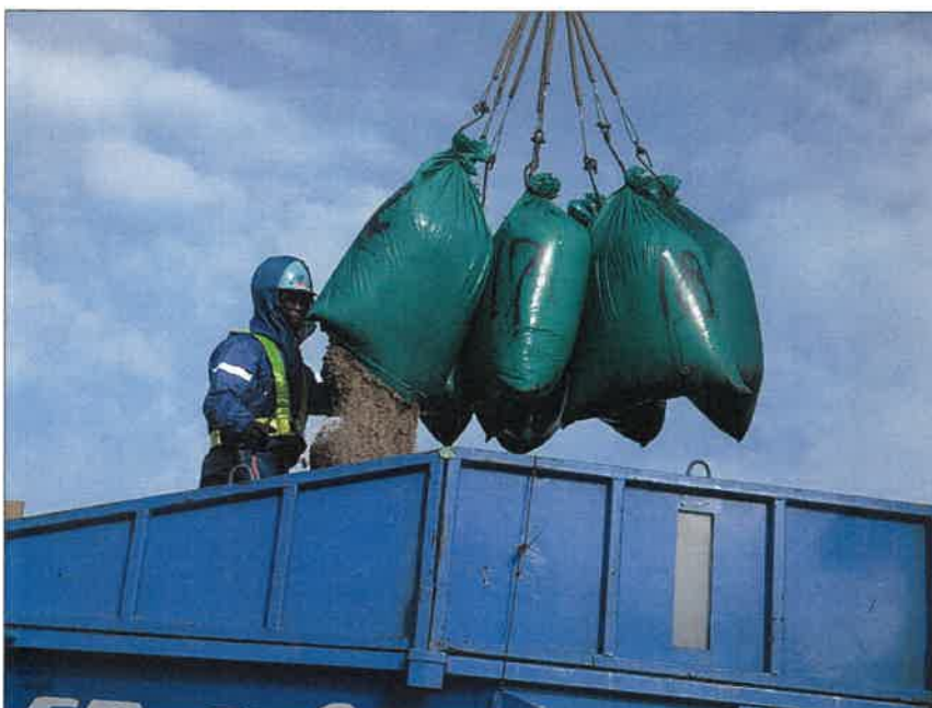
写真区分:施工状況写真 工種:2工区 田番 104-3 種別:吸水渠状況 写真タイトル:モミガラ積み込み状況
