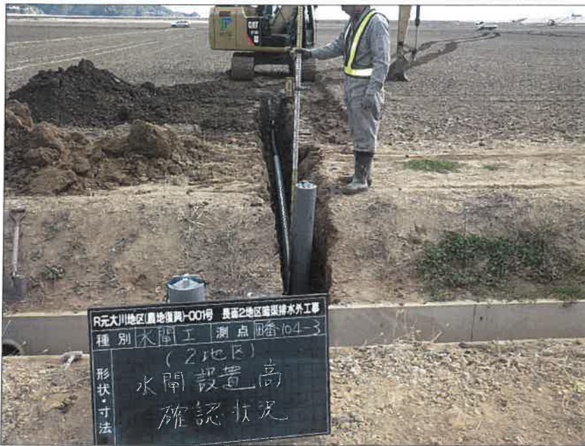
写真区分:施工状況写真 工種:2工区 田番 104-3 種別:水閘工状況 写真タイトル:水閘部設置高 確認
