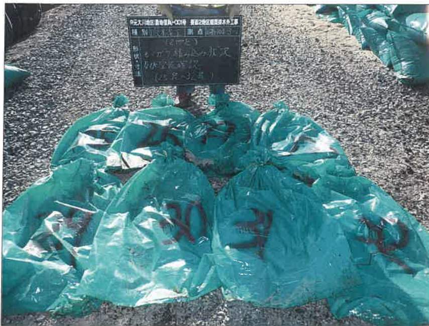
写真区分: 施工状況写真 工種: 2工区 田番 104-3 種別: 吸水渠状況 写真タイトル: モミガラ積込み後空袋確認
