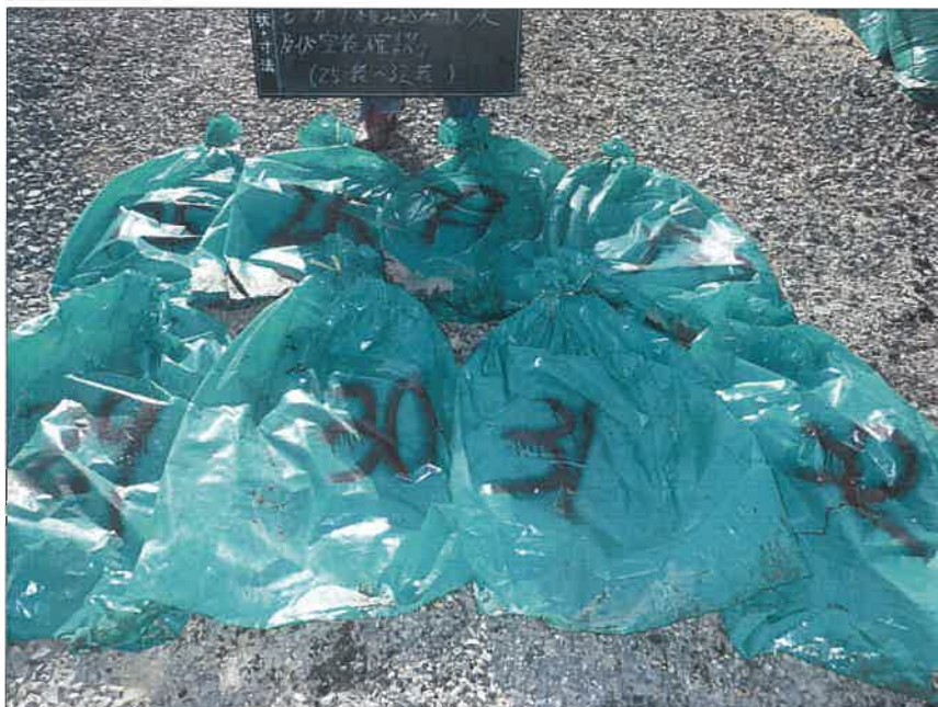
写真区分: 施工状況写真 工種: 2工区 田番 104-3 種別: 吸水渠状況 写真タイトル: モミガラ積込み後空袋確認
