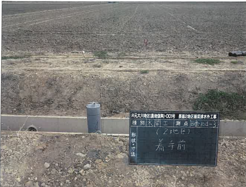
写真区分:施工状況写真 工種:2工区 田番 104-3 種別:水閘工状況 写真タイトル:着工前
