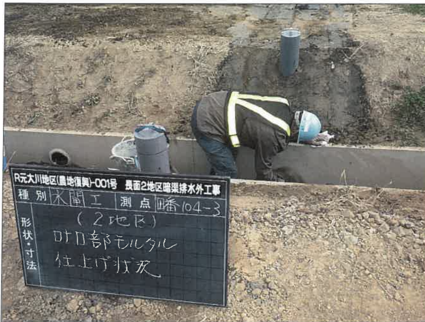
写真区分:施工状況写真 工種:2工区 田番 104-3 種別:水閘工状況 写真タイトル:吐口部モルタル 仕上げ状況
