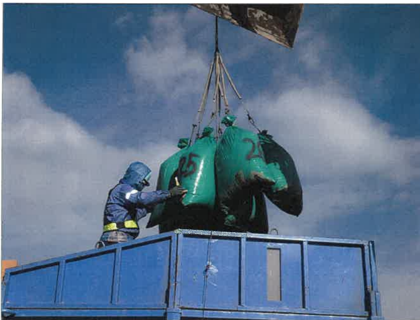
写真区分: 施工状況写真 工種: 2工区 田番 104-3 種別: 吸水渠状況 写真タイトル: モミガラ積み込み状況
