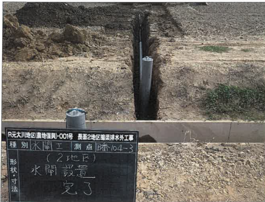
写真区分:施工状況写真 工種:2工区 田番 104-3 種別:水閘工状況 写真タイトル:水閘部設置完了
