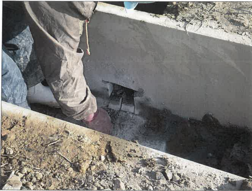
写真区分:施工状況写真 工種:2工区 田番 104-3 種別:水閘工状況 写真タイトル:吐け口開孔状 況
