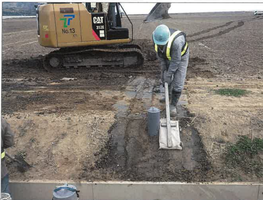
写真区分:施工状況写真 工種:2工区 田番 104-3 種別:水閘工状況 写真タイトル:埋戻し及び法 面仕上げ状況
