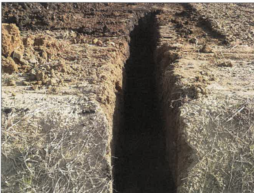
写真区分:施工状況写真 工種:2工区 田番 104-3 種別:水閘工状況 写真タイトル:床均し掘削完了
