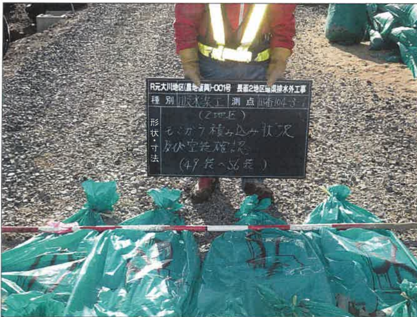
写真区分:施工状況写真 工種:2工区 田番 104-3 種別:吸水渠状況 写真タイトル:モミガラ積込み後空袋確認
