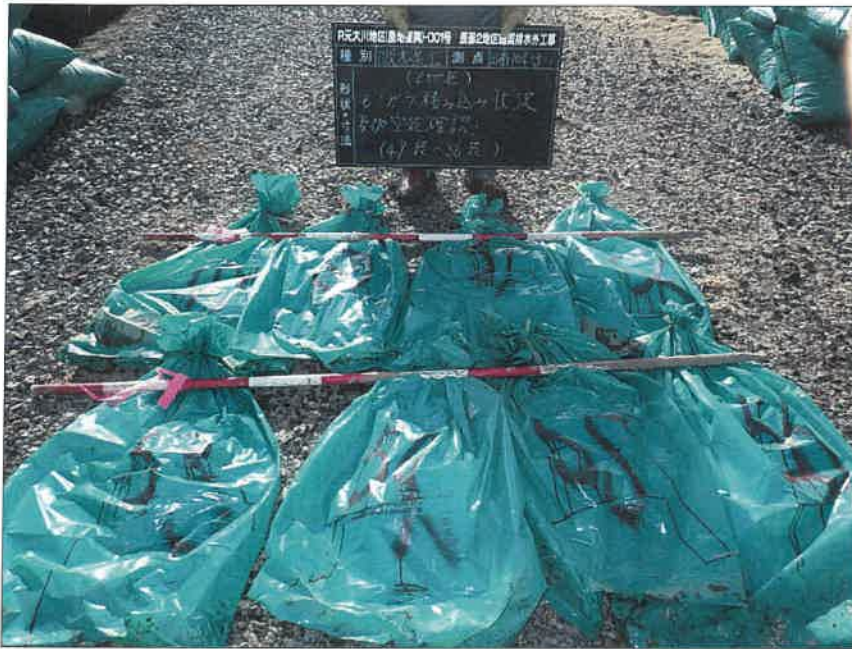
写真区分:施工状況写真 工種:2工区 田番 104-3 種別:吸水渠状況 写真タイトル:モミガラ積込み後空袋確認
