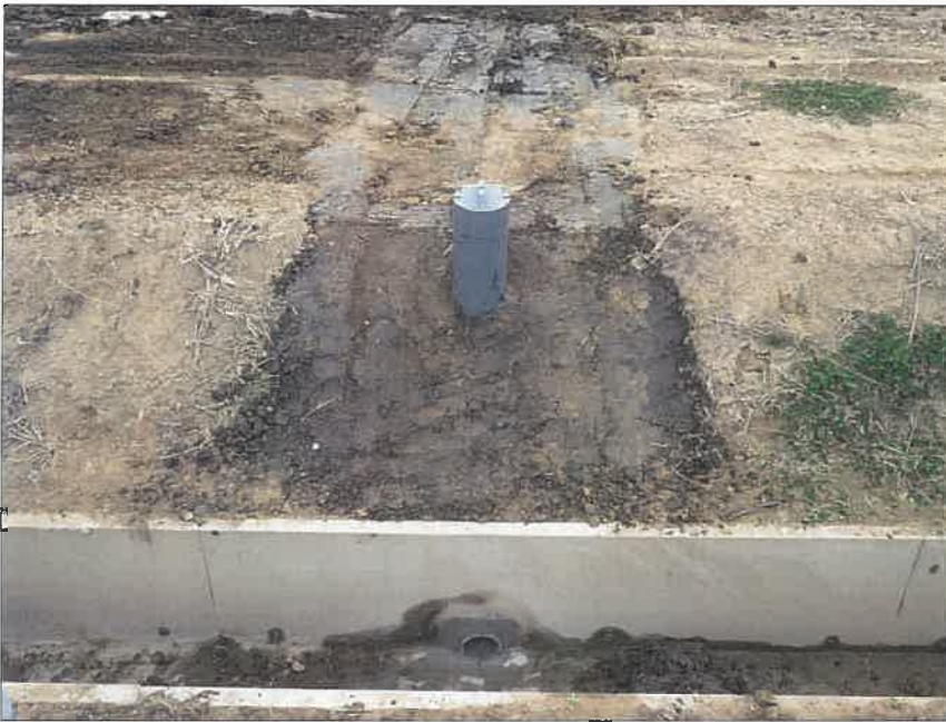
写真区分:施工状況写真 工種:2工区 田番 104-3 種別:水閘工状況 写真タイトル:水閘部布設完了
