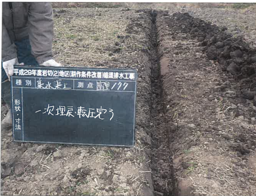
暗渠排水工 富里工区177 集水渠工 人力一次埋戻し・転圧状況(A ~B)
