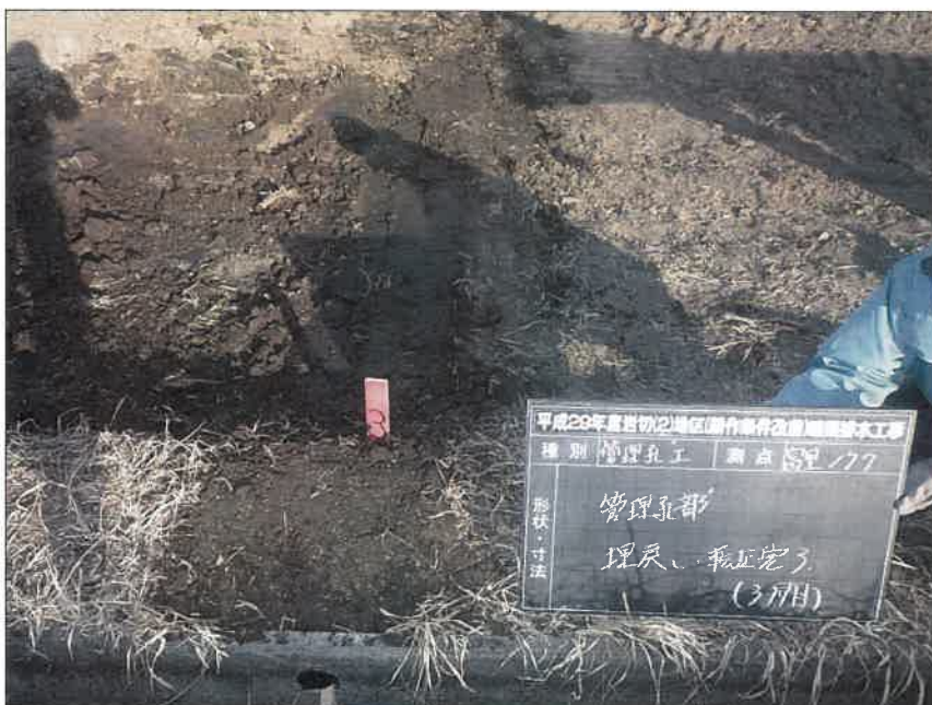
写真区分: 施工状況写真 工種: 暗渠排水工 種別: 富里工区177 細別: 管理孔工 写真タイトル: 管理孔部 埋 戻し・転圧完了(3層目)
