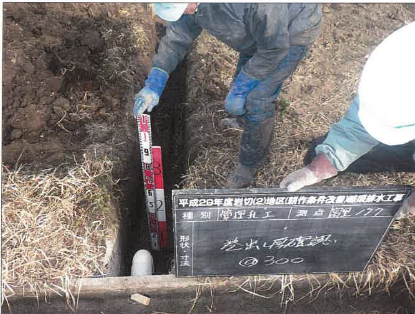
写真区分: 施工状況写真 工種: 暗渠排水工 種別: 富里工区177 細別: 管理孔工 写真タイトル: 巻出し厚確認
