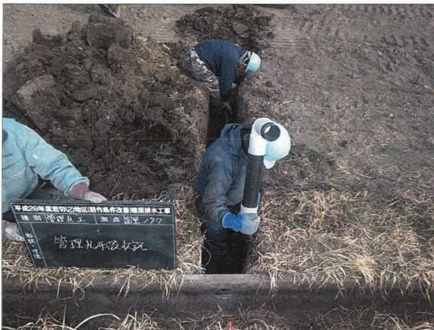
写真区分: 施工状況写真 工種: 暗渠排水工 種別: 富里工区177 細別: 管理孔工 写真タイトル: 管理孔布設状況
