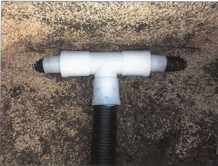
写真区分:施工状況写真 工種:暗渠排水工 種別:富里工区177 細別:管理孔工 写真タイトル:管理孔布設完了
