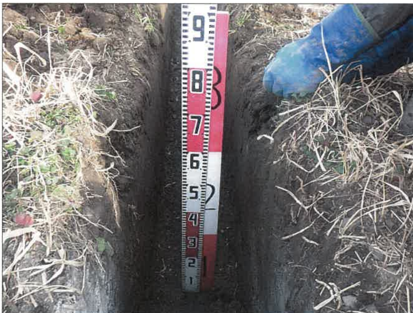
写真区分: 施工状況写真 工種: 暗渠排水工 種別: 富里工区177 細別: 管理孔工 写真タイトル: 巻出し厚確認 拡大
