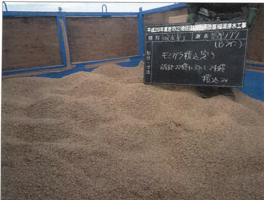
暗渠排水工 富里工区177 吸水渠工 モミガラ積込み完了 設計22袋に対して24袋積込み
