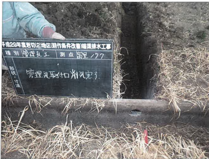
写真区分: 施工状況写真 工種: 暗渠排水工 種別: 富里工区177 細別: 管理孔工 写真タイトル: 管理孔取付口削孔完了
