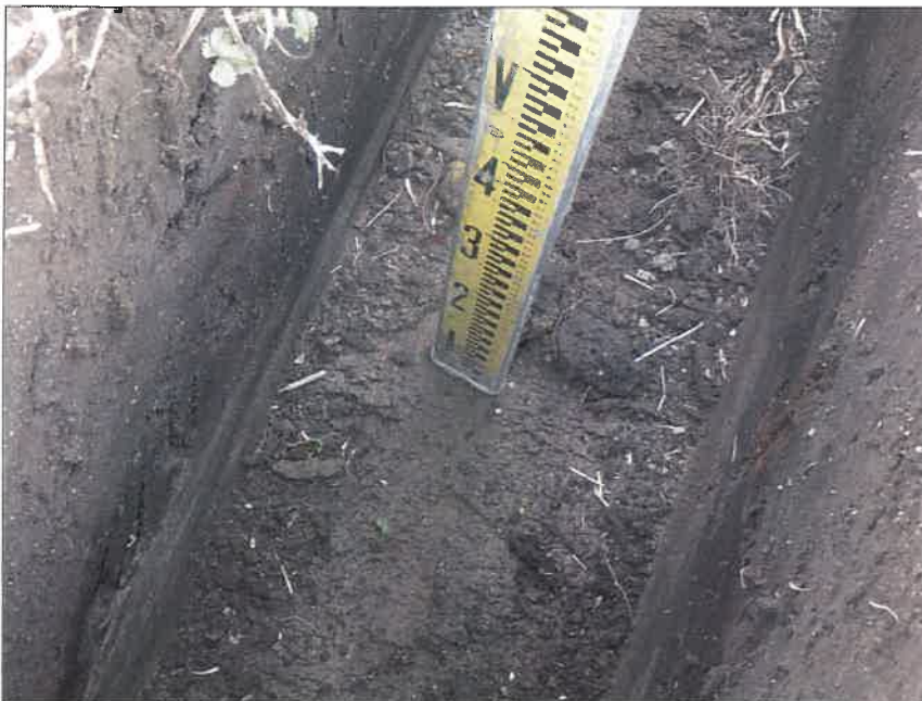
写真区分: 施工状況写真 工種: 暗渠排水工 種別: 富里工区177 細別: 管理孔工 写真タイトル: 掘削高測定状況 拡大
