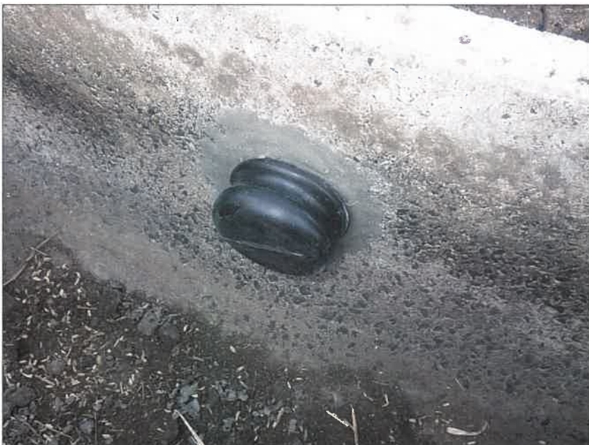
写真区分: 施工状況写真 工種: 暗渠排水工 種別: 富里工区177 細別: 管理孔工 写真タイトル: キャップ取付け完了
