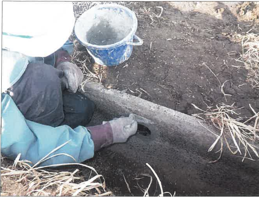
写真区分: 施工状況写真 工種: 暗渠排水工 種別: 富里工区177 細別: 管理孔工 写真タイトル: モルタル仕上げ状況
