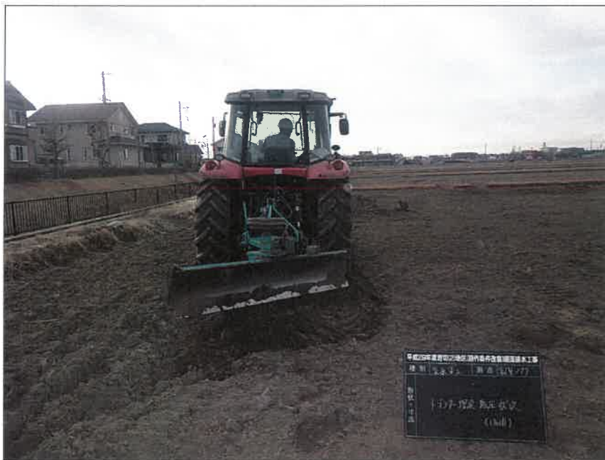
暗渠排水工 富里工区177 集水渠工 トラクター転圧状況(1回目)
