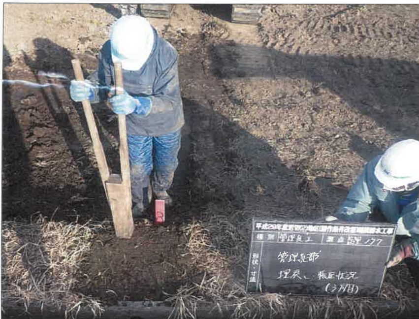
写真区分: 施工状況写真 工種: 暗渠排水工 種別: 富里工区177 細別: 管理孔工 写真タイトル: 管理孔部 埋 戻し・転圧状況(3層目)
